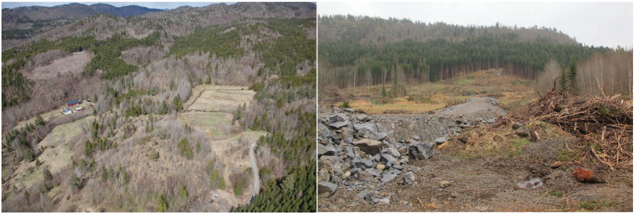
Figur 12.4. a/ Flygfoto över Gunnarsröd myr, foto mot norr. Foto: Jernbaneverket. b/ Översikt över myren från Gunnarsröd 4 mot öster, från 2013 då skogen avverkats och anläggningsarbetena påbörjats.
