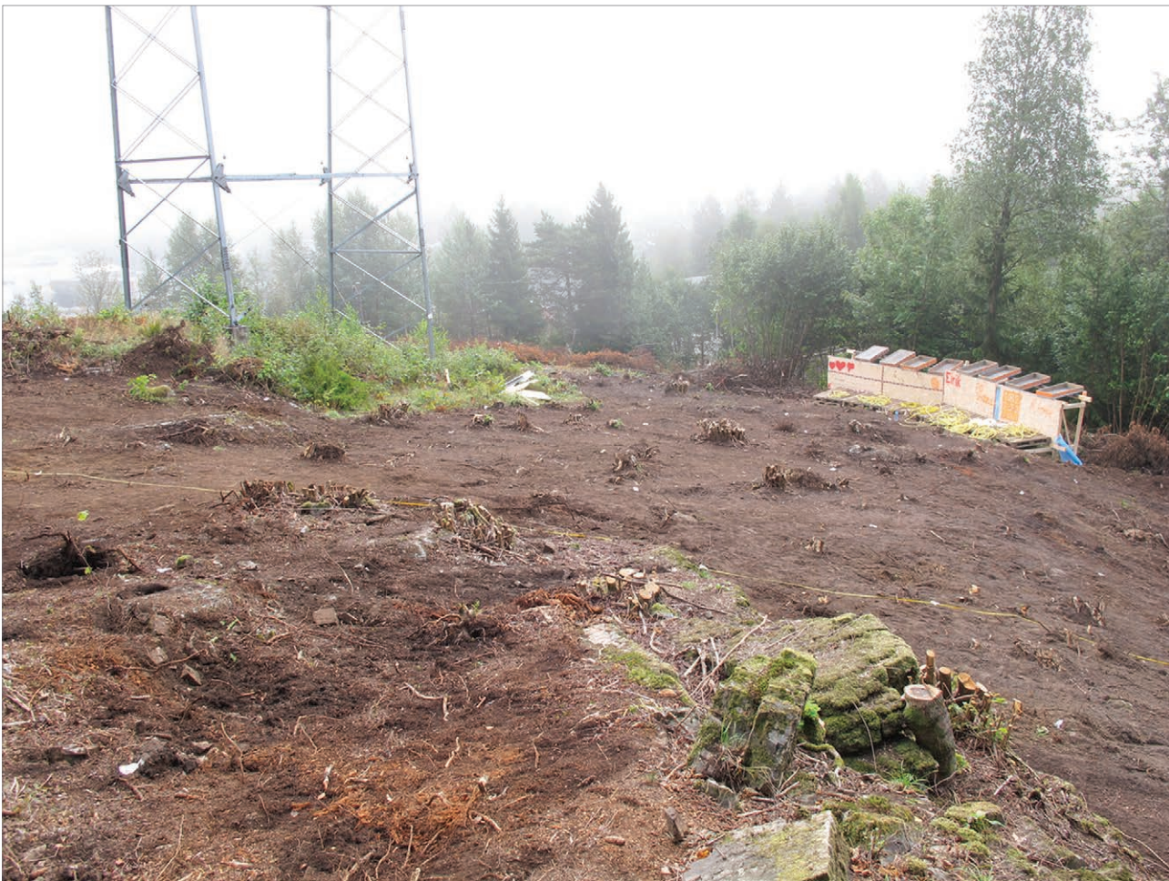
Figur 3.7. Høyspentmasten har forstyrret deler av flaten på felt B. Figure 3.7. Transmission tower construction has disturbed parts of «Felt B.»
