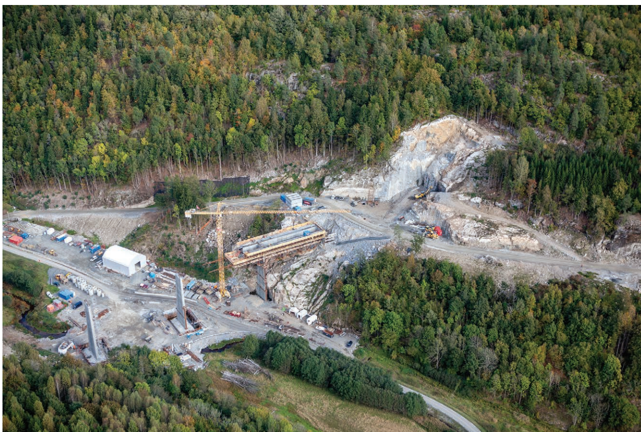
Figur 1.7. Flyfoto etter anleggsarbeidene startet i Langangen Vestgård-området, tunnel-innslaget er såvidt påbegynt, der lokaliteten Langangen Vestgård 1 lå. Foto mot nordøst. Foto: Jarle Foss/Jernbaneverket.
